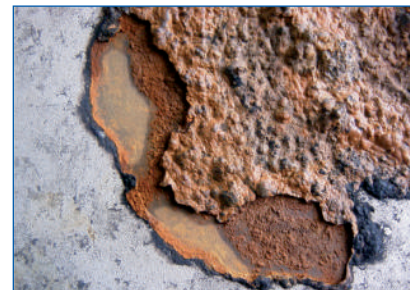
Korrosion und Kalk auf Metalloberflächen
